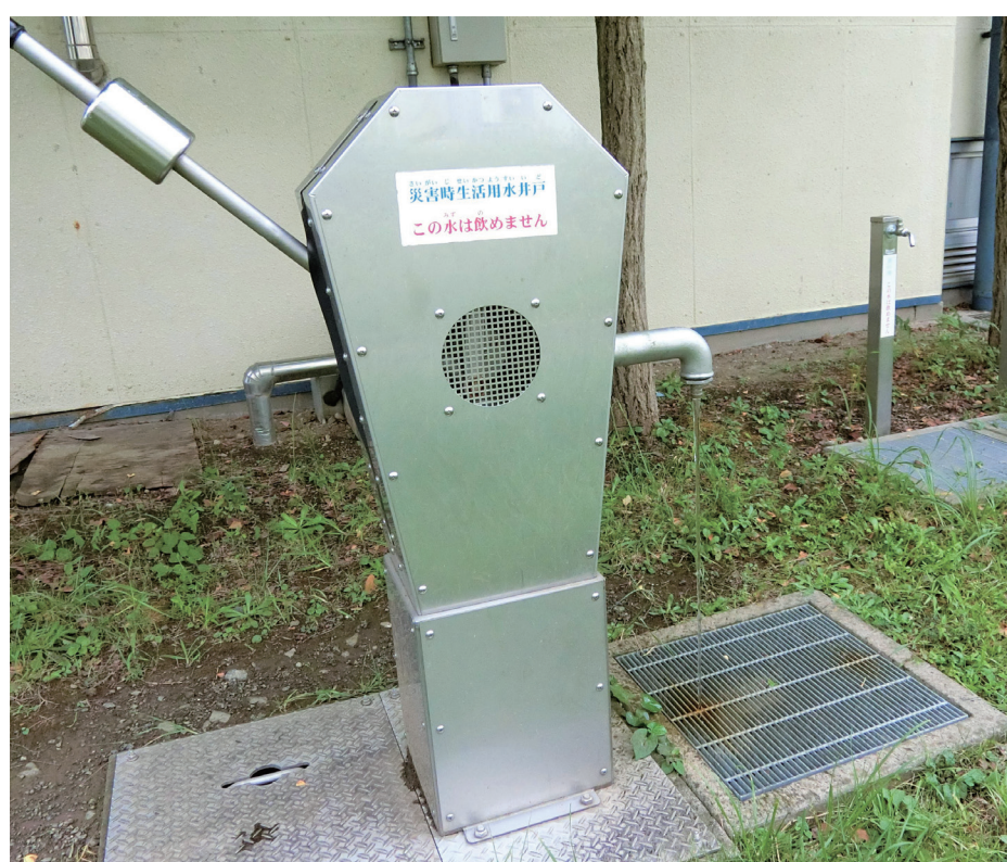
▲ふれんど平尾に整備している災害時生活用水井戸
