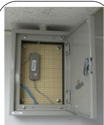
電話接続端子盤
