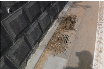
▲落ち葉が詰まった集水ます
