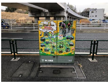
▲配電用地上機器ラッピング
