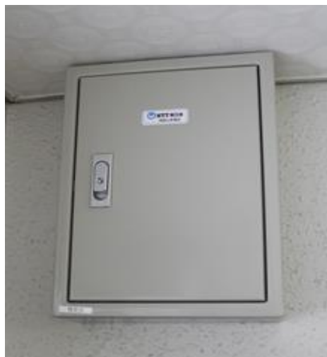
電話接続端子盤
