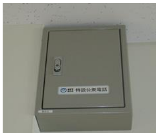
電話接続端子盤
