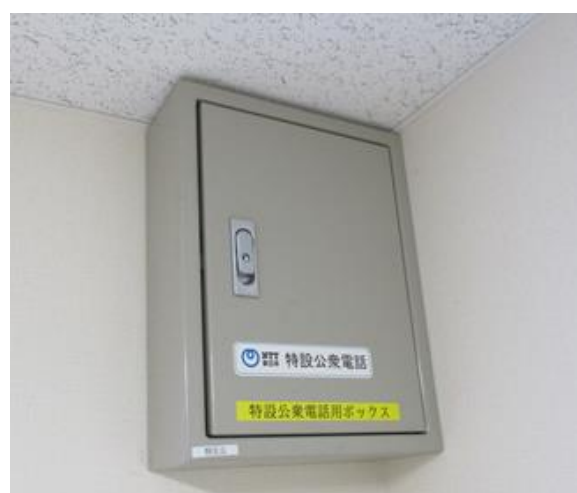
電話接続端子盤
